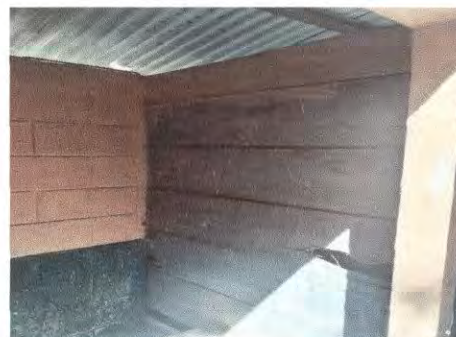
Foto 10: MODULO A SERVICIO SANITARIO Estructura de madera y lamina de zinc en mal estado. Se instalará piso cerámico, se eliminará tabique de madera por levantado de block
