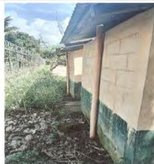
Foto 8: MODULO SERVICIO SANITARIO Se sustituirá estructura de madera en ma estado y la cubierta de lamina de zinc.
