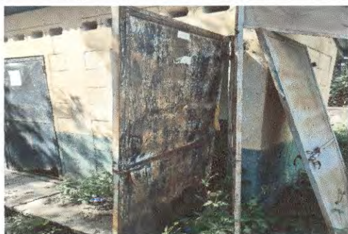
Foto 9: MODULO SERVICIO SANITARIO Puertas de metal en mal estado, se cambiarán por puertas de metal nuevas.
